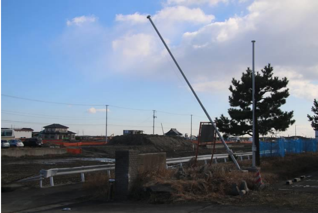
傾いたままの掲揚台 [「閑上中学校」正門付近]
