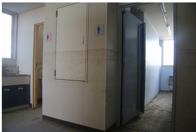
校舎内の壁には津波の痕跡が残っている
